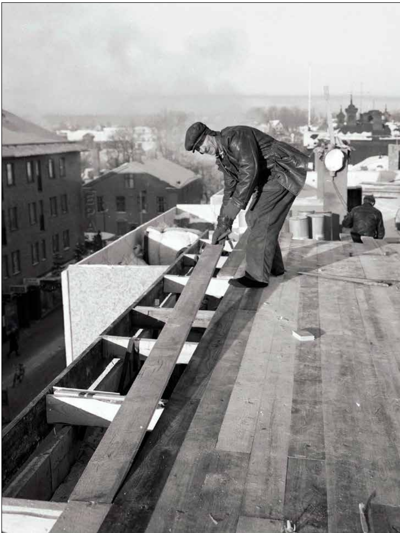
Det nya Domushuset tar form. Säkerhetselar och hjälm var inte riktigt aktuellt 1963. Mannen på bilden har inte långt kvar till kanten på taket.
